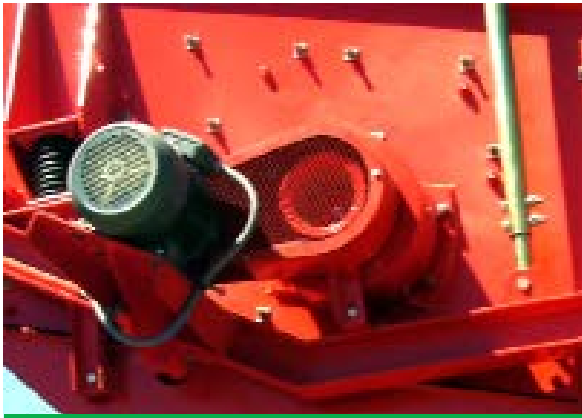
Antiguo sistema de instalación del motor.
